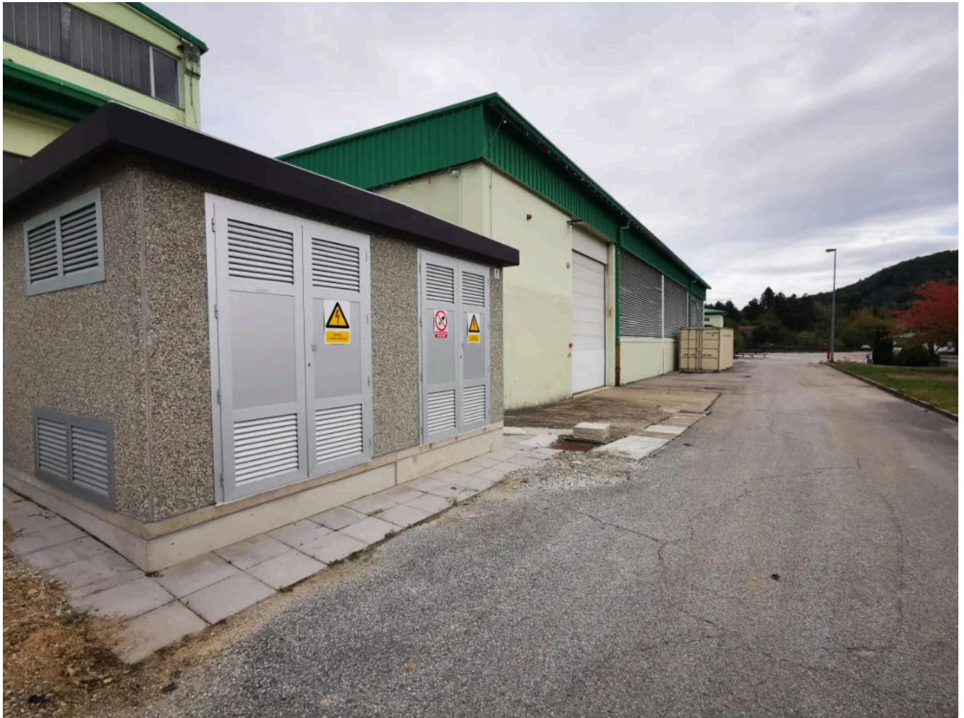
Nova trafostanica pored hale gdje se planira obrađivati otpad (Foto: Goran Štimec)
